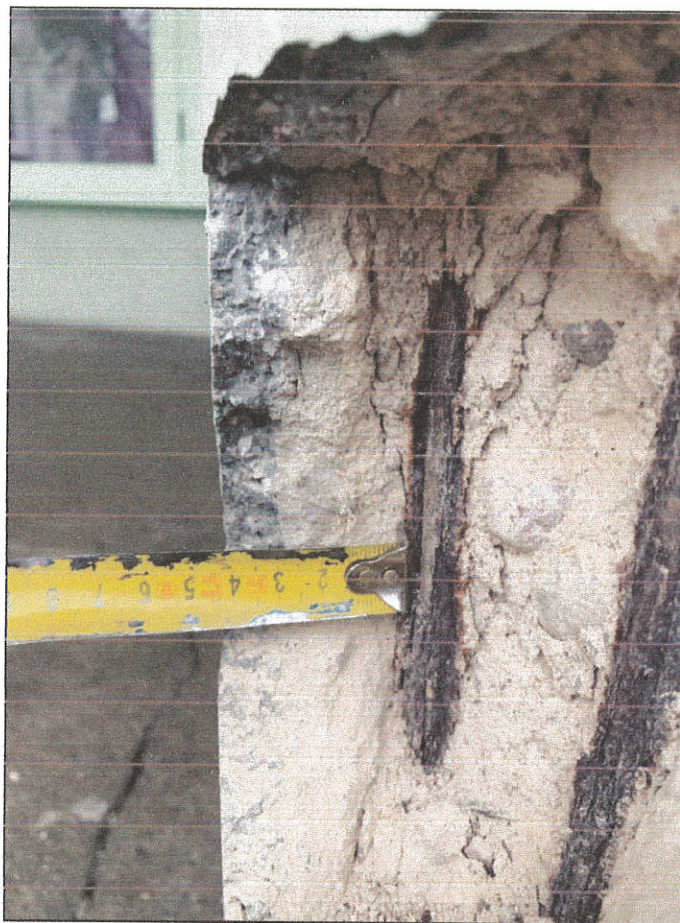
Zdj. Nr 9 Widok w przekroju otuliny prętów zbrojeniowych oraz lastrykowej okładziny zewnętrznej
