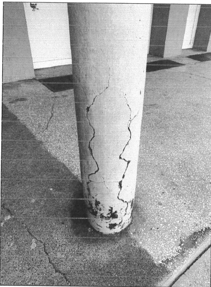
Zdj. Nr 5 Widok spękań słupa Nr 2 w strefie dolnej (przyposadzkowej)
