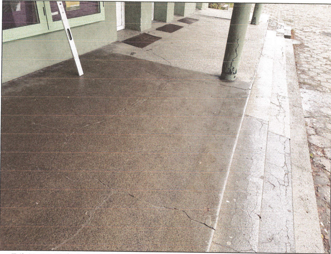
Zdj. Nr 19 Widok spękań posadzki podestu i stopni schodów wejściowych
