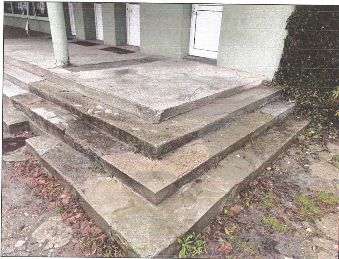
Zdj. Nr 20 Widok spękań posadzki podestu i stopni schodów wejściowych
