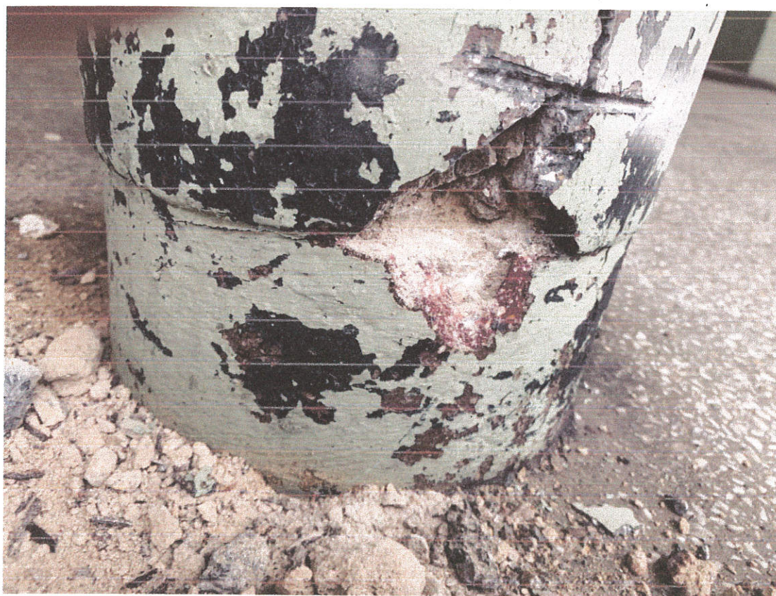
Zdj. Nr 10 Widok odkrywki stupa nr 2 tuż przy posadzce schodów wejściowych (widoczna inna okładzina stupa)
