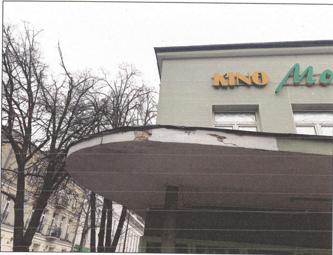
Zdj. Nr 15 Widok odparzeń i spękań tynku na czole pyty zadaszzenia
