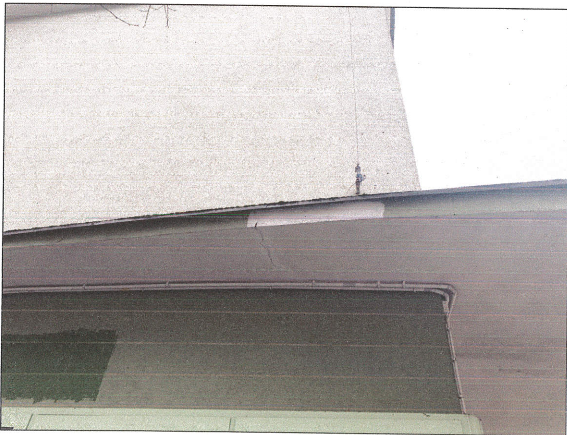
Zdj. Nr 16 Widok pęknięcia płyty zadaszzenia od strony ul. Staszica
