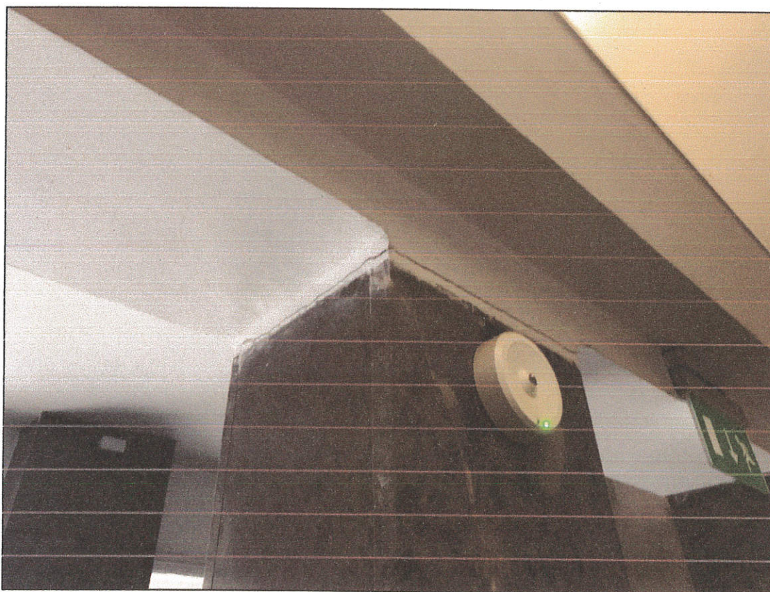
Zdj. Nr 14 Widok szczeliny między słupem wewnątrz budynku a belką
