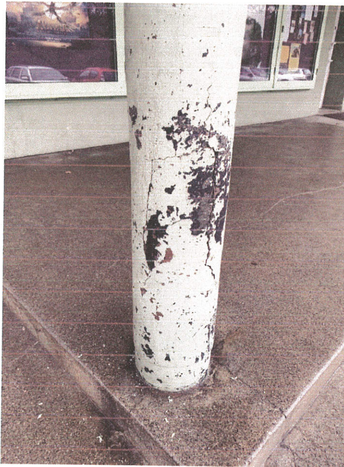
Zdj. Nr 3 Stup Nr 1 – widok spękań stupa w strefie dolnej (przyposadzkowej)
