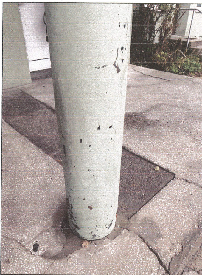
Zdj. Nr 13 Widok zarysowań słupa nr 3
