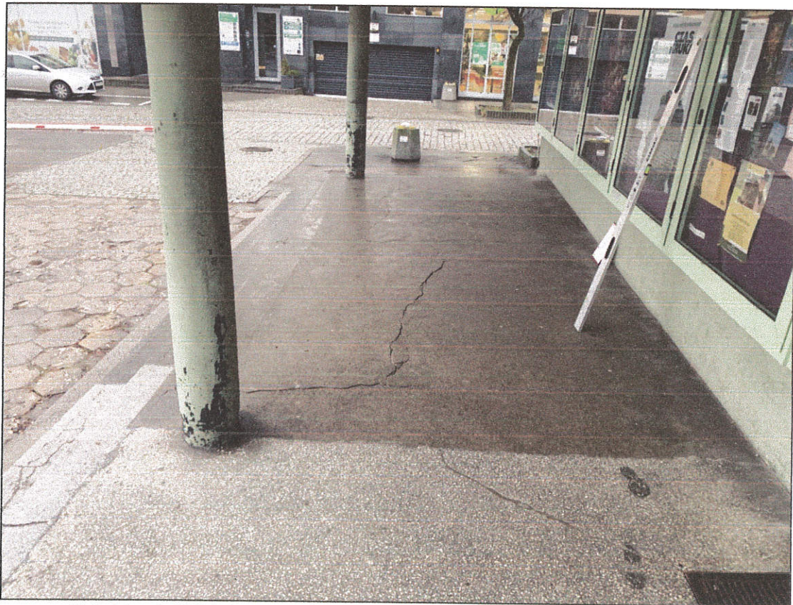
Zdj. Nr 18 Widok spękań posadzki podestu schodów wejściowych
