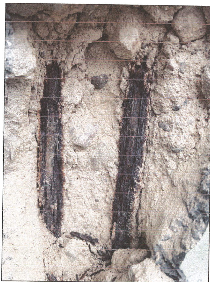
Zdj. Nr 8 Widok korozji prętów zbrojeniowych w wykonanej odkrywce słupa Nr 2
